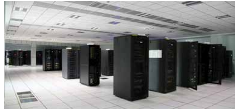
पृथ्वी पर्यवेक्षण उपग्रहों के लिए एकीकृत बहुमिशन भू खंड (आईएमजीआईओएस) में अत्याधुनिक आंकड़ा केन्द्र State of the Art Data Centre in Integrated Multimission Ground Segment for EO satellites (IMGEOS)
