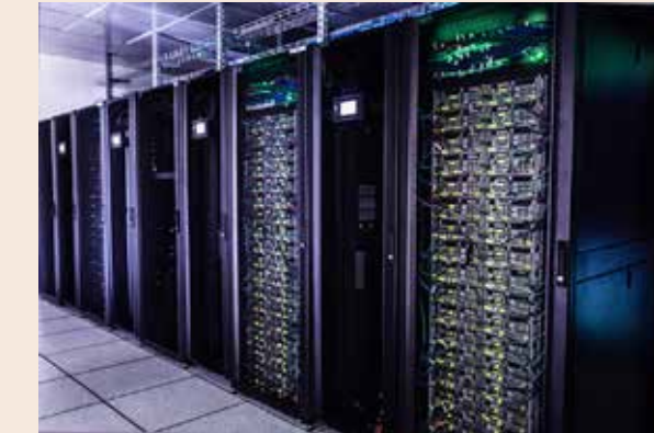
पेटा-माप उच्च निष्पादन कंप्यूटिंग प्रणाली (पीएआरएएम एएमबीएआर) Peta-scale High Performance Computing System (PARAM AMBAR)
