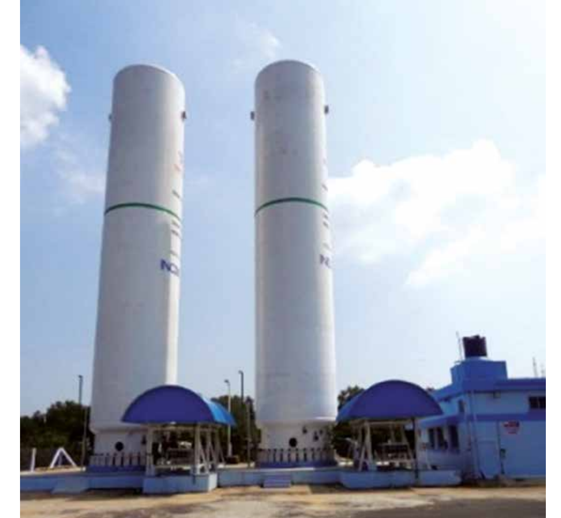
एलएन 2 भंडारण सुविधा LN2 Storage Facility
